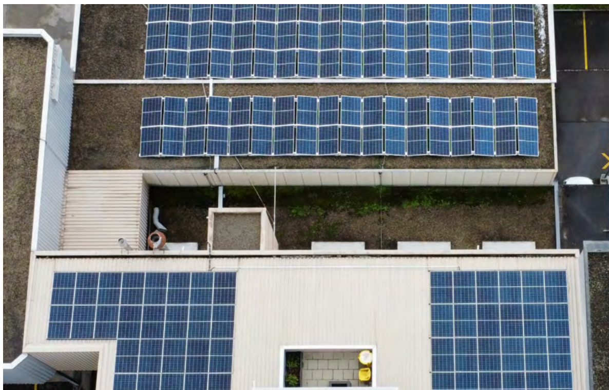
Die Photovoltaikanlagen liefern Strom en masse.
