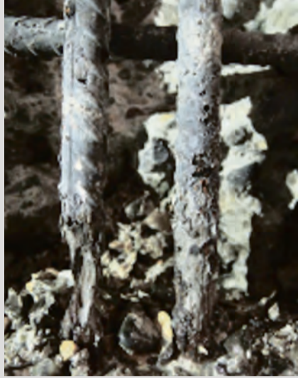
Durch Lochfrass fast vollständig durchkorrodierte Bewehrung (Bild U. Angst, ETHZ)
