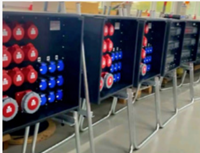
Stromverteiler à gogo.
